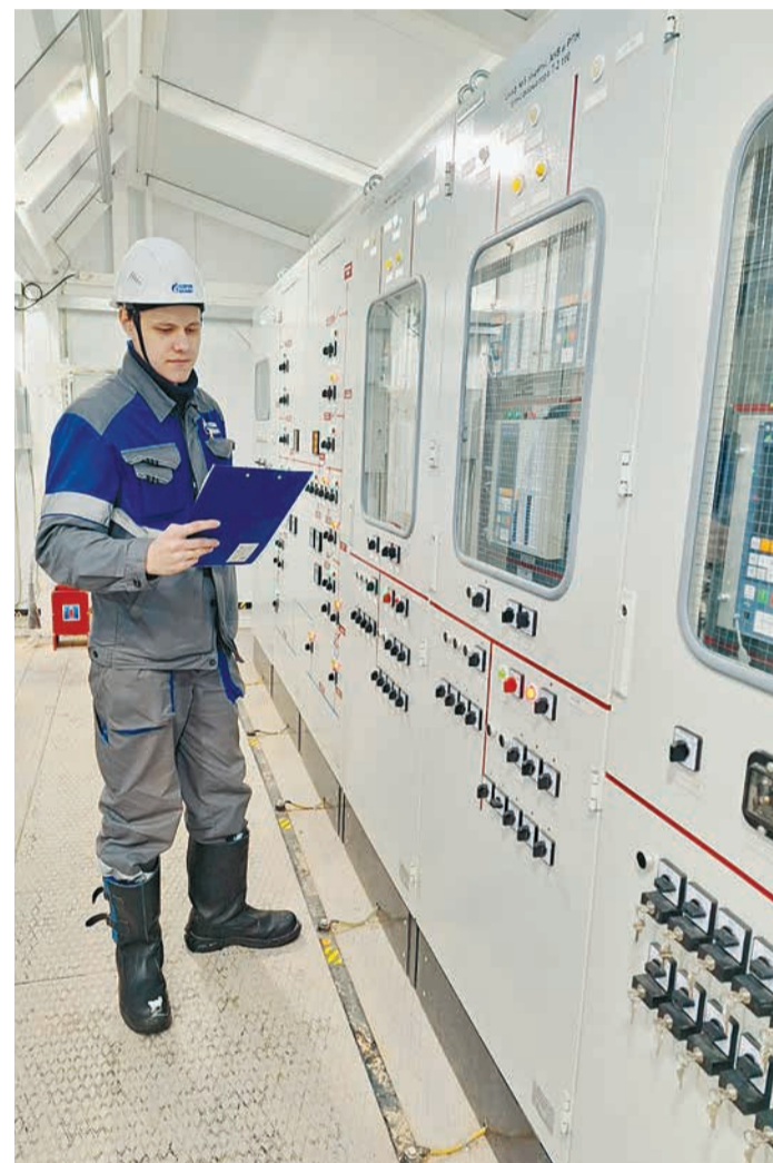
Мастер на ПС 110 кВ УКПГ-2
