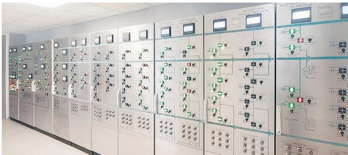
Оборудование ПС 110 кВ УКПГ-2
