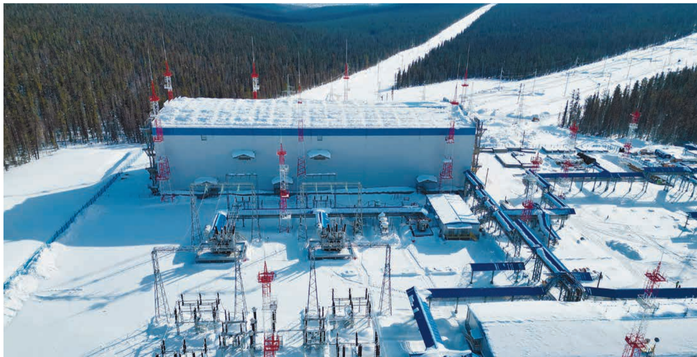
ПС 220 кВ «Ковыкта»
