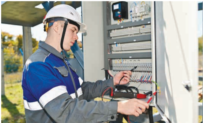
Монитор по ремонту аппаратуры, релейной защиты и автоматики Максим Полосухин за работой на ПС 35/10 кВ «Павловка»
