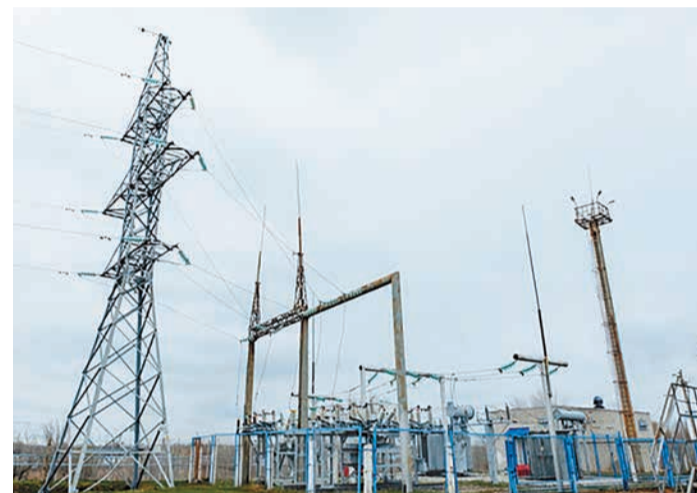
Подстанция водозабора на реке Бузан
