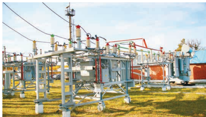
ПС 35/10 кВ КС «Сызранская»
