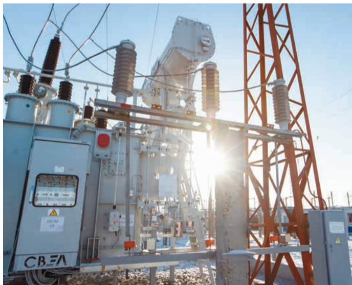
Модернизированное силовое электрооборудование на ПС «9 Января»
