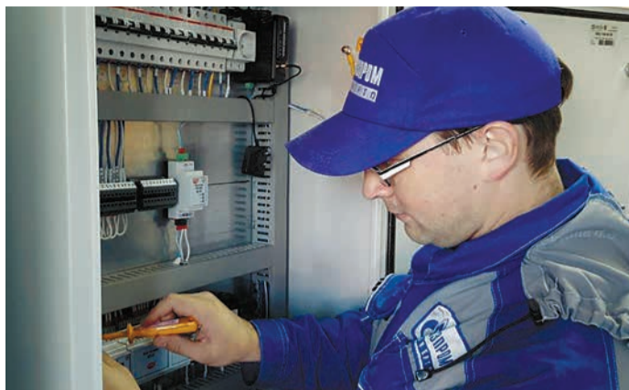
Техническое обслуживание АСКУ ЭР
