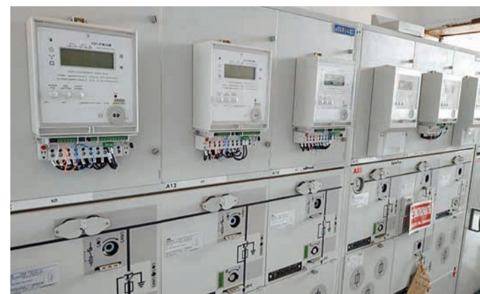
Автоматизация учета электроэнергии в РП-10кВ
