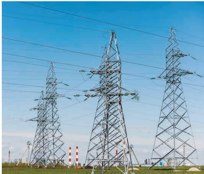
Коридор ВЛ-110 после переустройства
