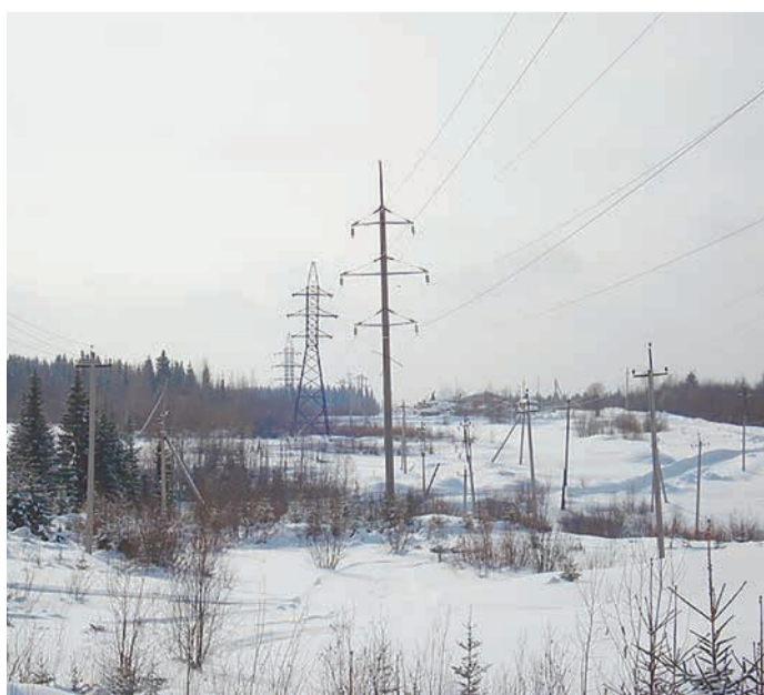
Воздушные линии 10 кВ «ГАЗ-1», «ГАЗ-2» ПС 35 кВ «Нюксеница»
