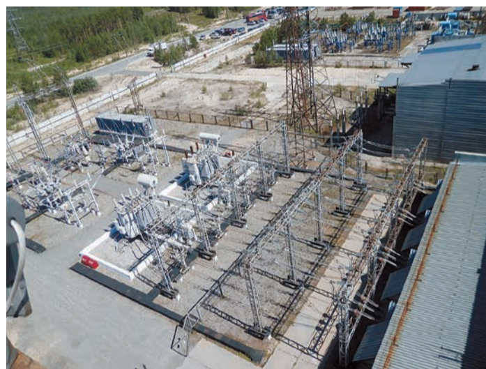
Открытое распределительное устройство на подстанции «Конденсат»
