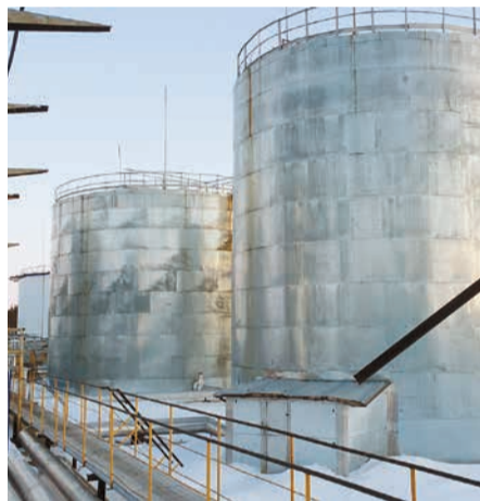
Комплекс очистных сооружений
