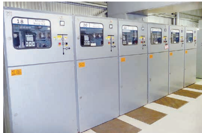
Закрытое распределительное устройство
