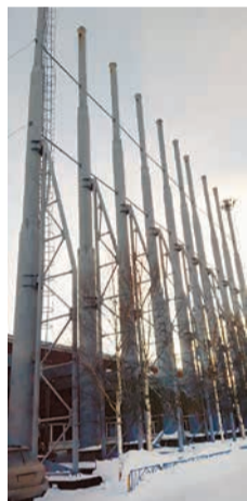
Котельная цеха энергводоснабжения
