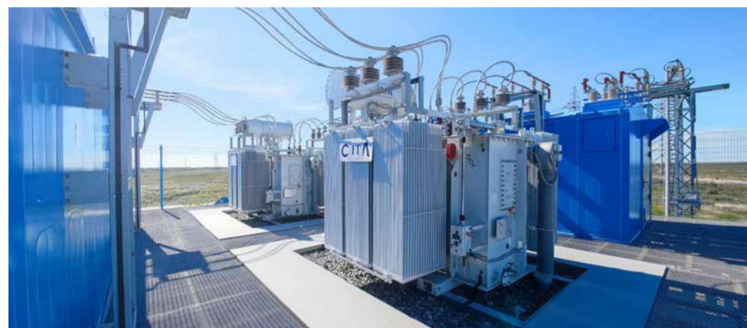
Подстанция трансформаторная повышающая 6/10 кВ
