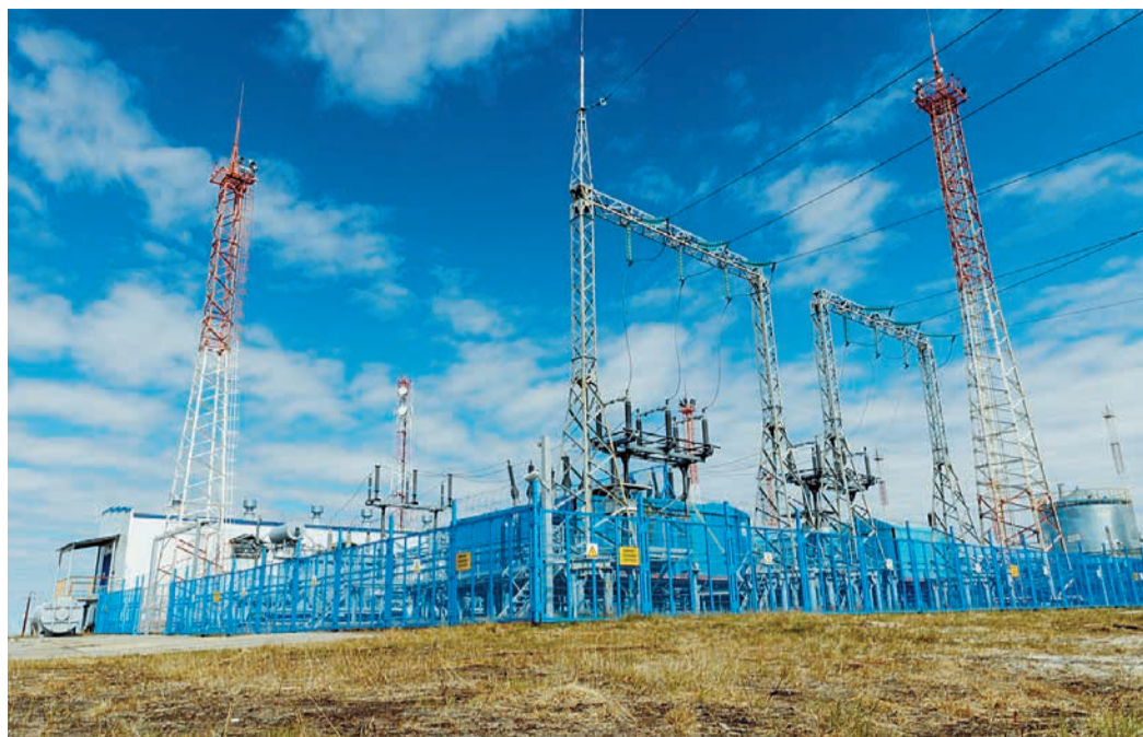
Подстанция ПС 110/10 ГКС
