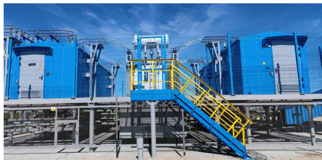
Подстанция 6/10 кВ (общий план)
