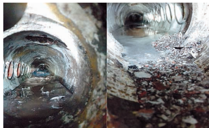
Нижние коллекторы заднего и фронтального экрана котлов БКЗ-75/39 после химической очистки
