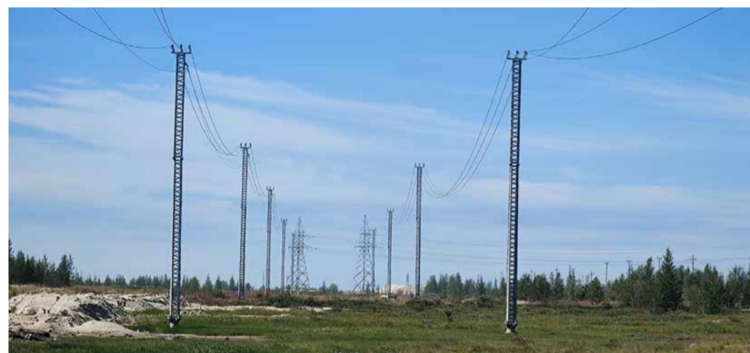
Воздушная линия с проводом СИП-3 3(1x240) к УКПГ-21
