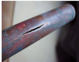
Повреждение трубы из-за локального перегрева
