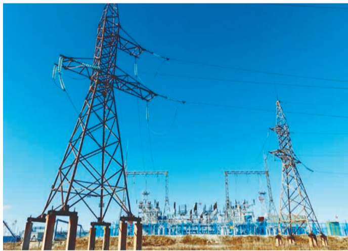
Воздушная линия 110 кВ в тундре
