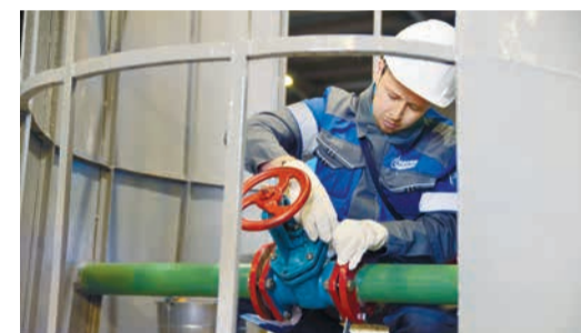
Ревизия запорной арматуры
