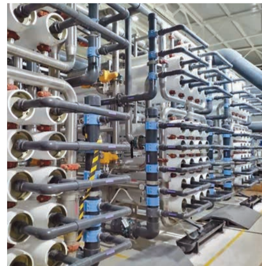
Обратноосмотическая установка Южного филиала ООО «Газпром энерго»
