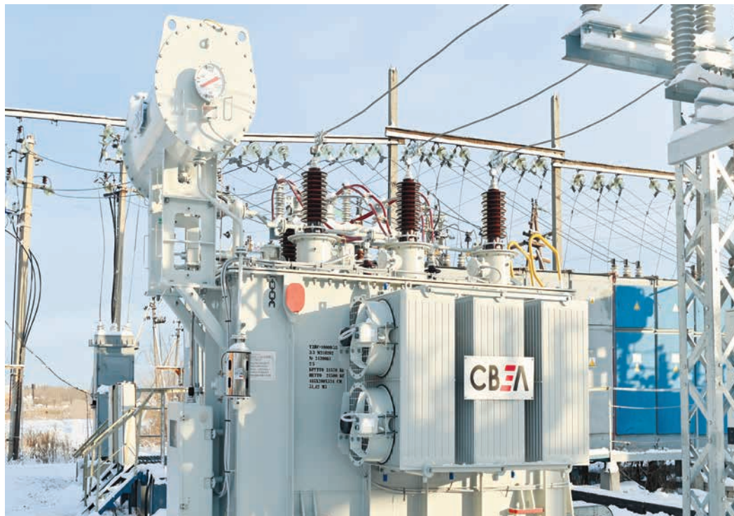
ПС «9 Января». Замененный трансформатор ТДНС-10000/35/10
