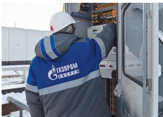
ПС «9 Января». Проверка цепей РПН (регулировки под нагрузкой) трансформатора
