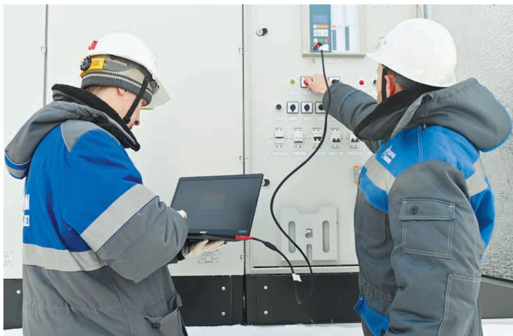
ПС «9 Января». Проверка микропроцессорных устройств РЗА с применением современного оборудования
