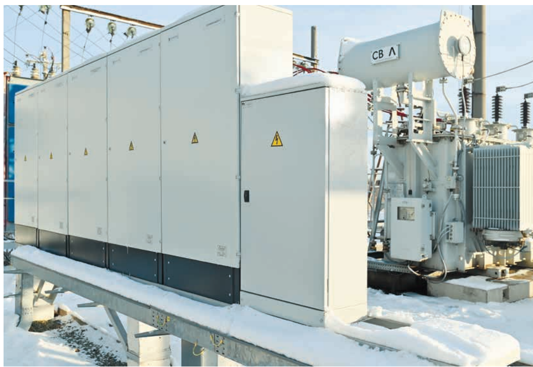
ПС «9 Января». Шкафы РЗА (релейной защиты и автоматики)
