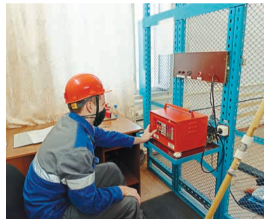
Проведение испытания средств защиты
