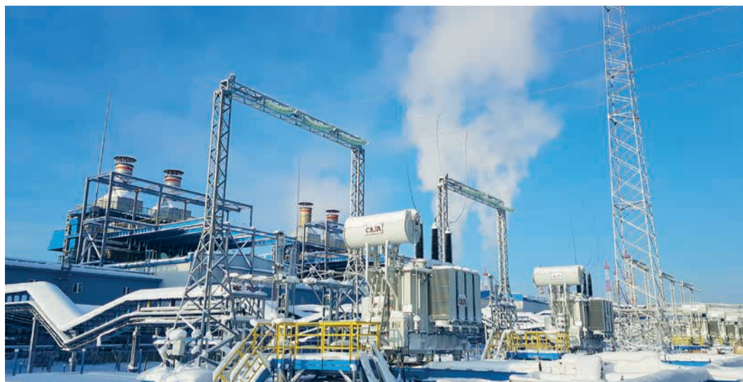
Открытое распределительное устройство 110 кВ Чайиндинской ЭСН-72
