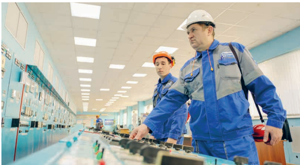
Операторная пусковой котельной. Эксплуатационный режим котлов БКЗ
