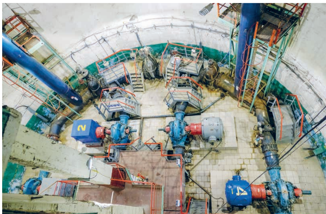
Насосная станция водозабора на реке Бузан
