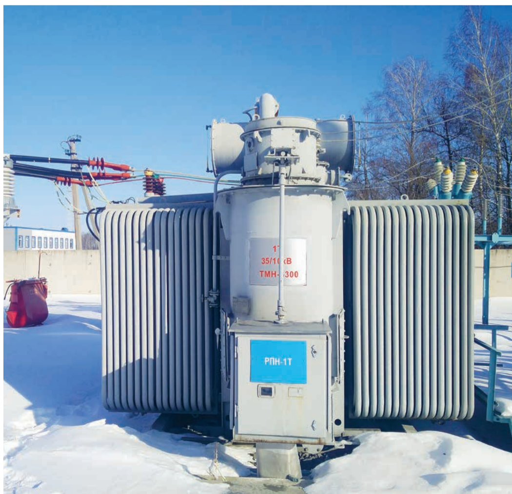
Подстанция 35/10 кВ «Москово»
