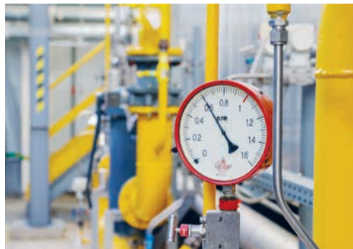
Газовое оборудование котлов
