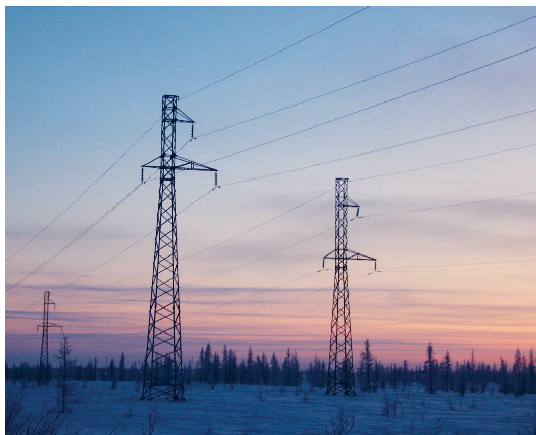
Воздушные линии 110 кВ
