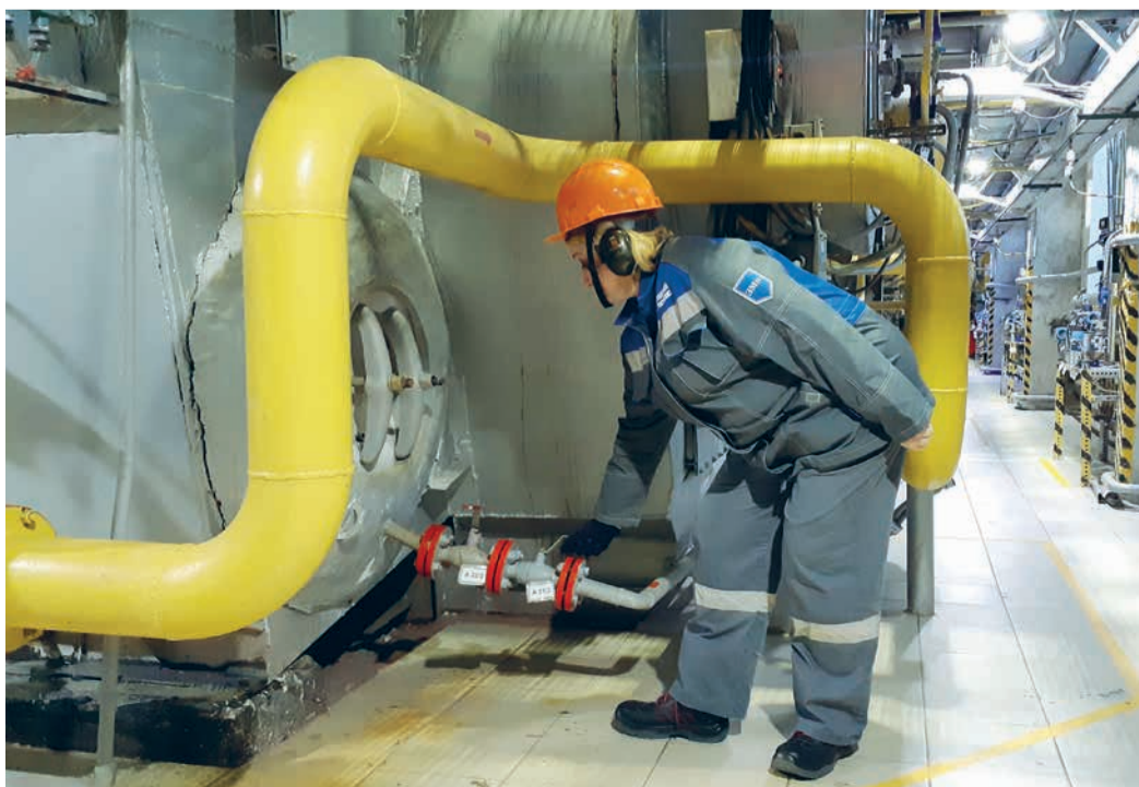
Оператор котельной производит осмотр и продувку котла
